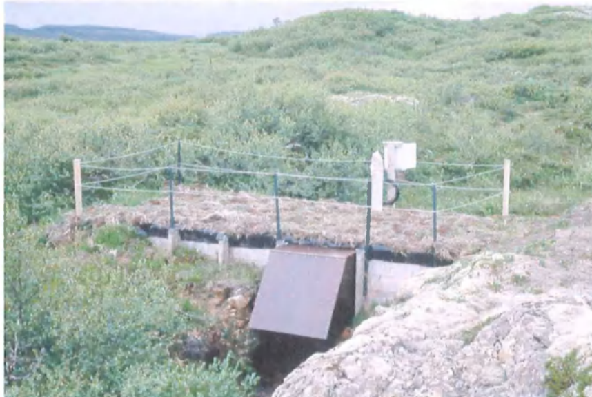
2. ljósmynd. Stífla í afrennislis- læk. Byggt var yfir stífluna og kassi settur yfir afrennli til að draga úr rennislis- truflunum vegna ísmyndunar. Ljós. Sigurður H. Magnússon, 31/7 1998.
